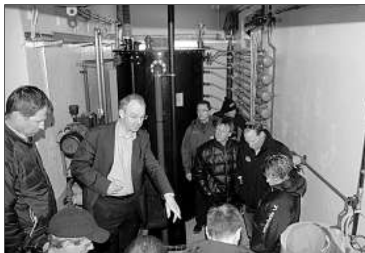
Praxiserfahrungen auf den Forumstouren: vollautomatische Kläranlage in der Bergstation auf dem Corvatsch, 3303 m ü. M.
